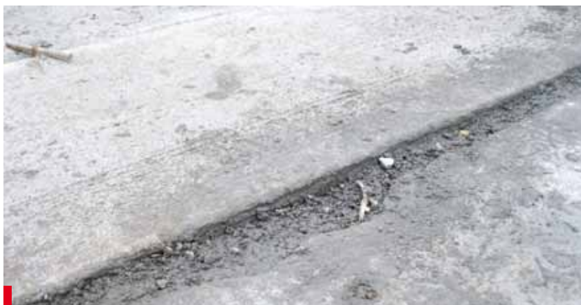
Fot. 1. Takie podłoże przekazano dekarzowi do wykonania hydroizolacji w układzie 2 x papa zgrzewalna
