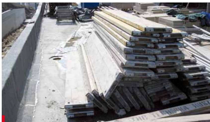
Fot. 14. Dach wykonany i odebrany to nie składowisko ani śmietnik
