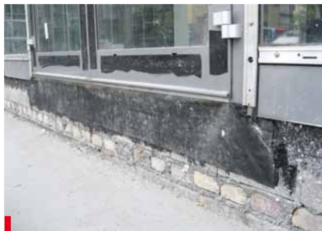
Fot. 10. Fartuch uszczelniający z EPDM powinien zostać przyklejony dopiero po wykonaniu hydroizolacji płyty stropowej i ściany (tutaj 2 x papa zgrzewalna)
