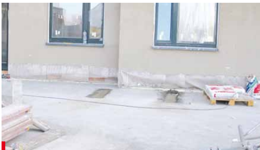
Fot. 7. Naturalne rozwiązanie problemu — rusztowanie zostało rozebrane, a cokół budynku będzie wykończony dopiero po wykonaniu hydroizolacji
