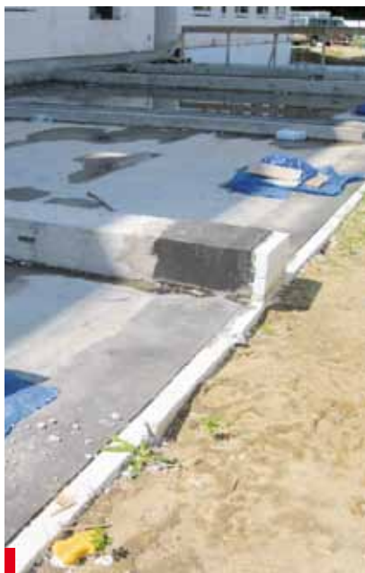
Fot. 3. Ścianę garaży trzeba będzie odkopać, a izolację zerwać
