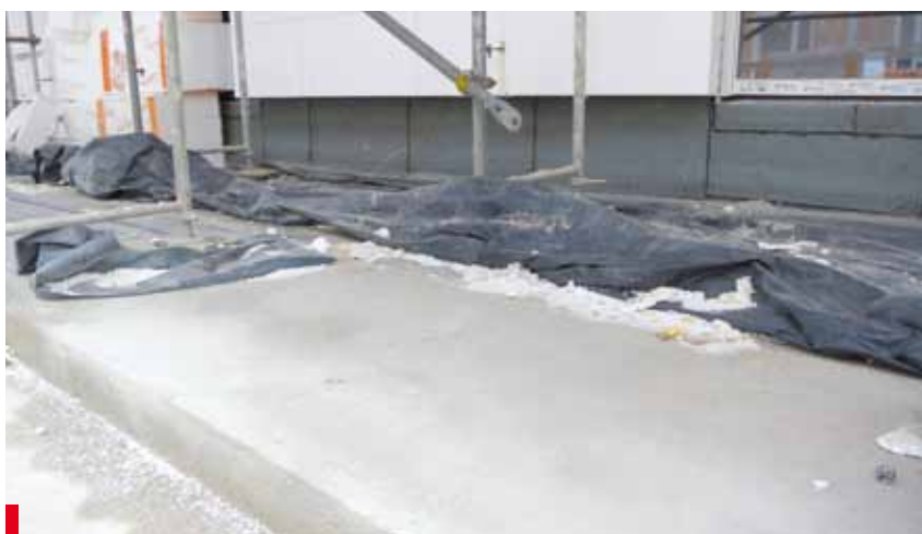
Fot. 8. Przykład rozwiązania kompromisowego — obróbkę dekarzką ściany wykonano przed ustawieniem rusztowania, a hydroizolacja stropu będzie wykonana po zakończeniu wszystkich prac elewacyjnych i rozebraniu rusztowania
