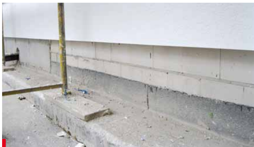
Fot. 6. Dekarz pracujący palnikiem nie będzie miał możliwości wykonania obróbki hydroizolacji (tutaj 2 x papa zgrzewalna) na wymaganej wysokości na ścianie ocieplonej styropianem
