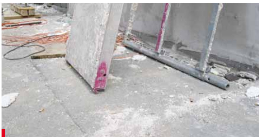
Fot. 15. Sytuacja niedopuszczalna, ale możliwa, jeżeli na budowie zawodzi nadzór
